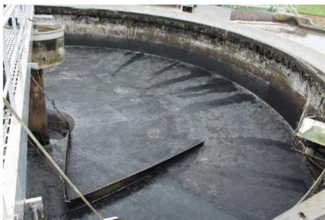
Image 1 : Lame de fond avant intervention
